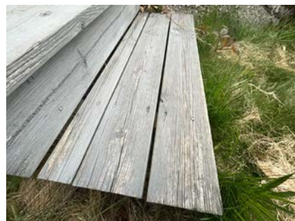
Noe slitasje registrert på overflater.
