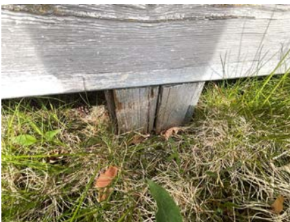
Bilde viser eks. på råteforekomster i understøtte/fundament.
