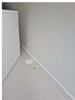
Det er montert et blendløkk over det største hullet.
