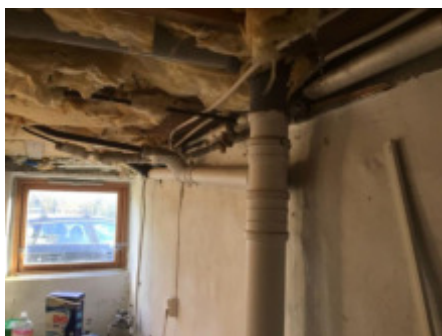
Avløpsrør i vaskerom
