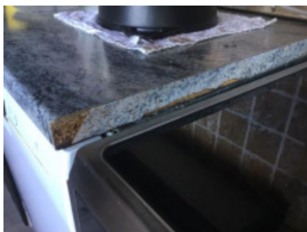
Skader på benkeplate
