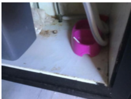
Fukt skader i skap under vask
