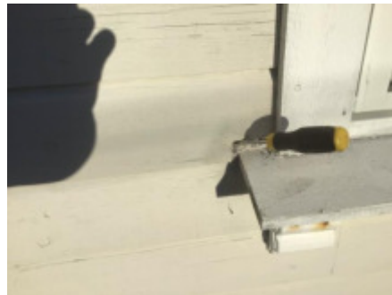
Råteskader ved vindu
