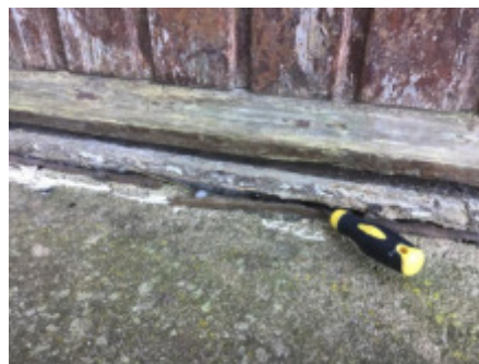
Uttett under kjellerdør
