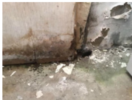
Synlige fukt skader
