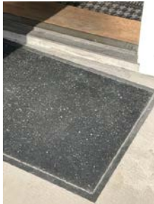
Ikke beslag under dør. Tetting mot betongdekke er usikker/ukjent.
