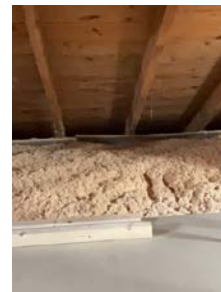
Luftespalte mot undertak ved takfot. Det er ikke luftespalte i utvendige gesimser.
