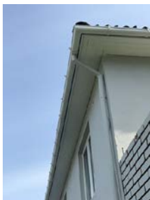
Noe aldringstegn og værslitasje på renner.
