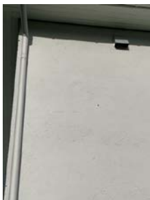
Mindre sprekkdannelse/riss i overflate - under gesims
