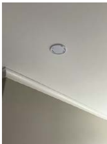
En varsler er demontert- kun holder i himling.
