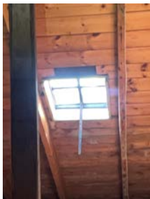
Takvindu - eldre fuktskjolder på undertak under vinduet.
