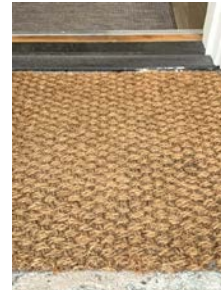
Ikke beslag under dør. Tetting mot betongdekke er usikker/ukjent.
