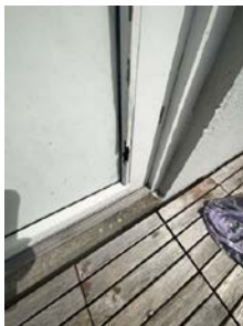
Fukt/råteskade i dørbled - balkongdør til soverom
