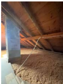
Ikke understøttelser - bjelke under sperrer.
