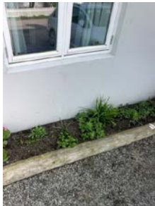
Sprekkdannelse i muroverflate - under vindu.
