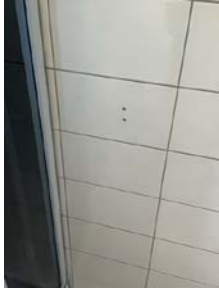
Skruehull i veggflis ved dusjkabinett
