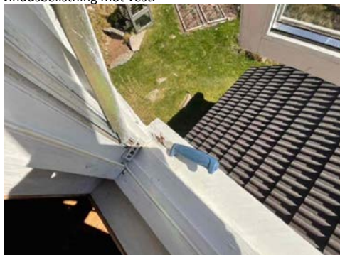
Råte i vannbord under vindu mot øst.
