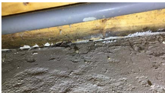
Fukt skader i overgang vegg/gulv
