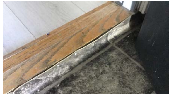
Belegg løsner under dør
