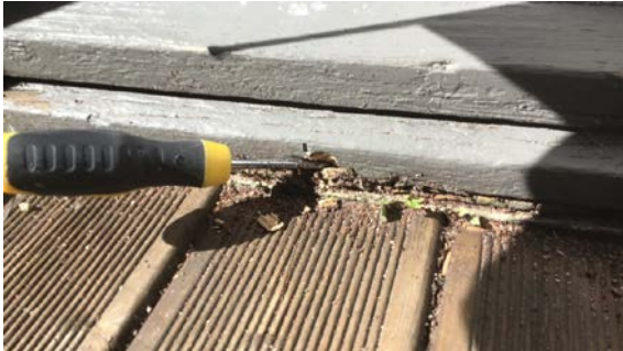
Råteskader i nedkant kjellerdør
