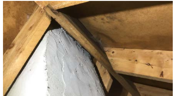
Fuktmerker langs gjennomføringer i undertaket
