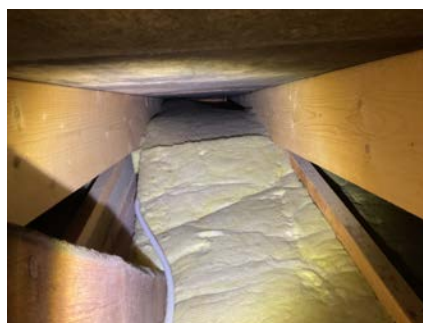
Svak isolering flere steder.
