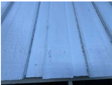
Skader i kledningen.
