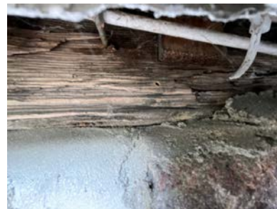
Fukt i bunnsvill i front.
