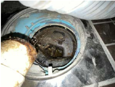
Synlig membran i sluken.
