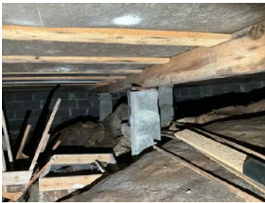
Dårlig fundamentering av pipen.
