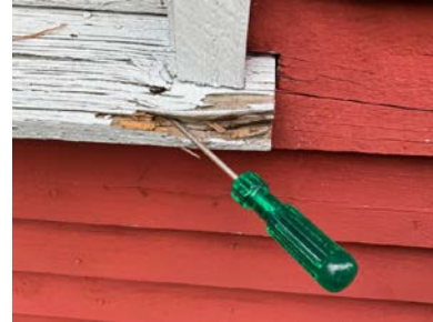
Råte i vindu omramming.
