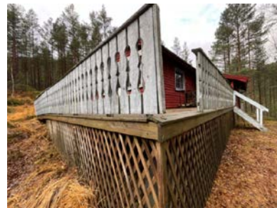
Skjevheter i bæringen.
