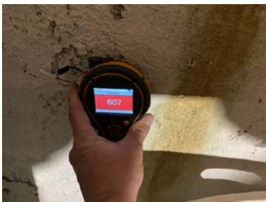
Økende mot gulvet, tyder på fuktopptrekk fra grunnen.
