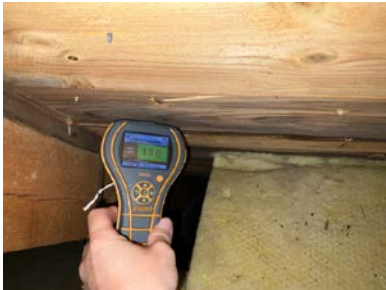
13.6 vektprosent i undertaket.
