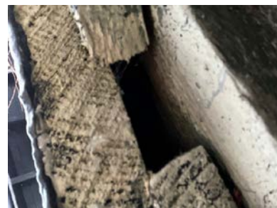
Underbord uten lufting og ingen musesperre.
