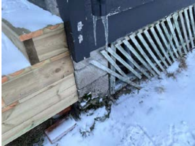
Vann fra taket renner ned rett ved pilarene.
