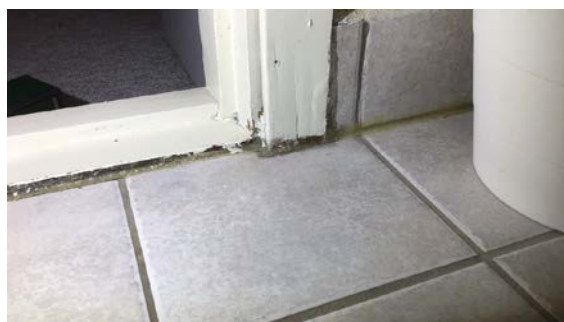
Skader i nedkant dør
