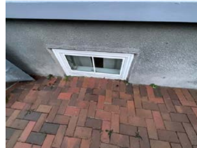
Fare for råte og vann inn bygget
