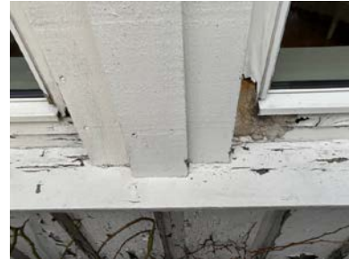
Råteskader i karmene.
