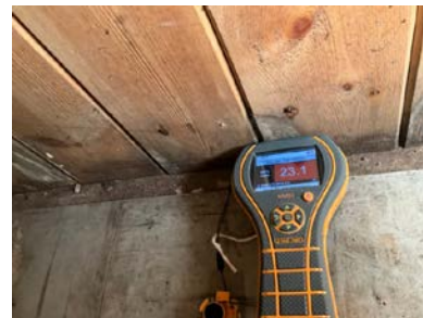
Fukt i overgang mellom grunnmur og treverk.
