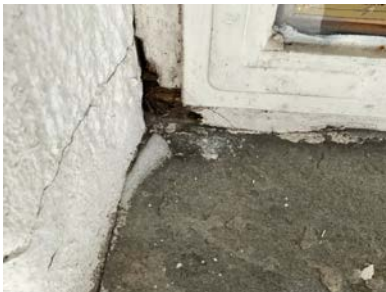
Liten råteskade i bunnen.
