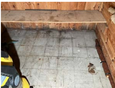
Fuktmerker i boden.
