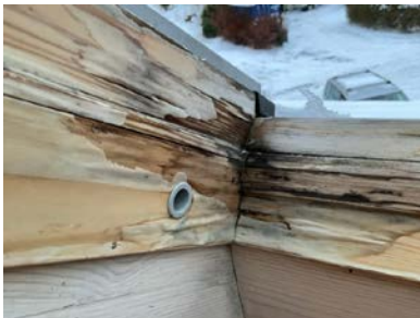
Råteskader i takvindu.
