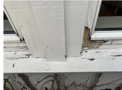
Råteskader i karmene.
