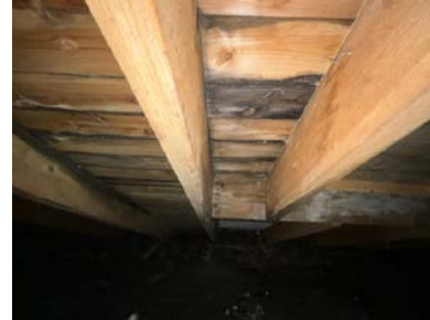
Fuktskjolder i undertak, men ingen unormale verdier på befaringdagen.
