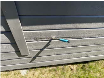
Enkelte dårlige bord på rekkverk/skjørt rundt terrasse
