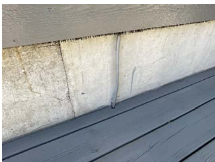
Utvendig ledning skal være beskyttet
