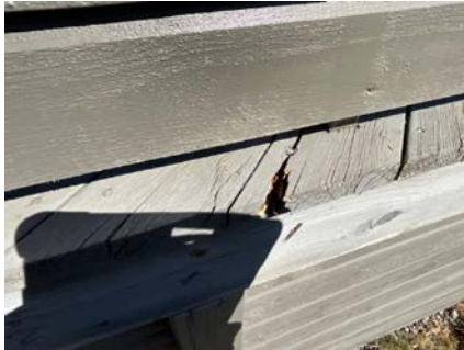
Enkelte dårlige terrassebord
