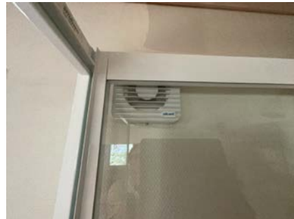
Elektrisk avtrekksvifte er plassert bak/helt inntil dusjkabinett.
