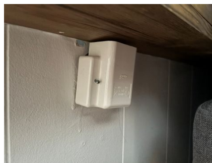
Løs kontakt på soverom brukt til komfyr ved utleie tidligere.
