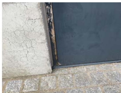
Dør inn til garasje, mindre fuktskade i karm og dør.
