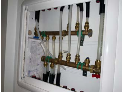
Fordelerskap for bruksvann.
