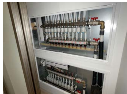
Fordelerskap for vannbårenvarme
