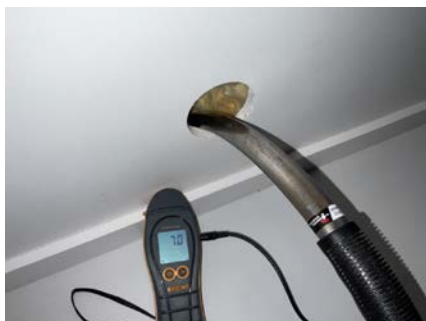
Hull tatt i påforet vegg i kjellerstue.
