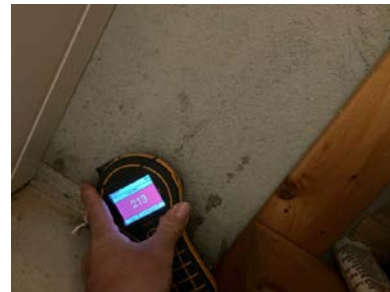
Økende fukt mot gulvet.
