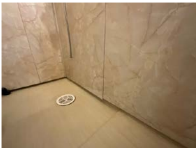
Skader på platene i dusjsonen.
