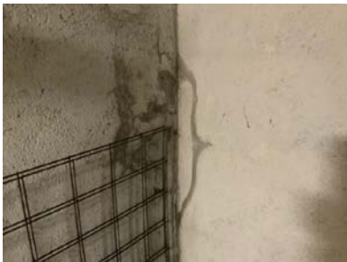
Fuktmerker på veggene.
