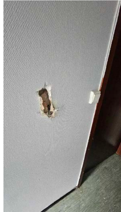
Skade på vegg i bakgang til butikk
