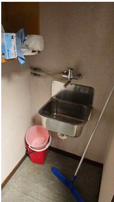
Utslagsvask på bøttekott.
