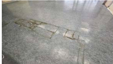
Skader på gulvbelegg i butikk
