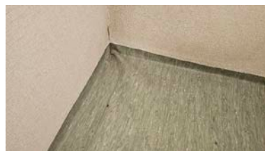
Gulvbelegg har løsnet, sannsynligvis pga fukt
