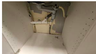
Koblinger under vask i innredning i butikkdel.
