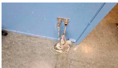
Vannrør i butikk som bør sjekkes nærmere.
