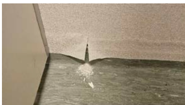
Salt/kalkutslag som følge av fukt.
