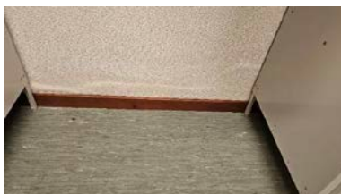
Det er tydelig spor etter fukt i vegg
