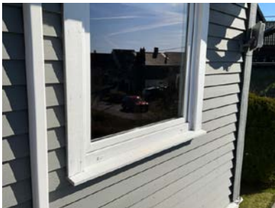
Mangler beslag under vinduet.
