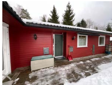
Eldre renner med rust og utettheter.
