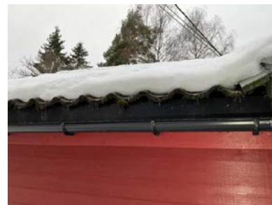
Fuktighet på undertaket.
