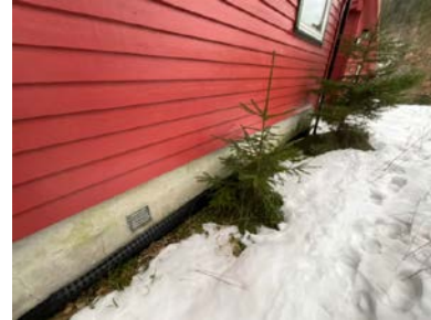
Mangler topplist på fuksikringen.
