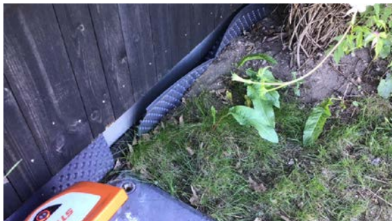
mangler klemlist på topp grunnmursplast
