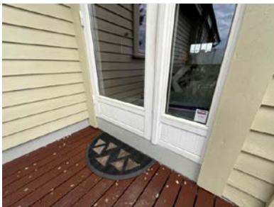
Fuktskader på døren.
