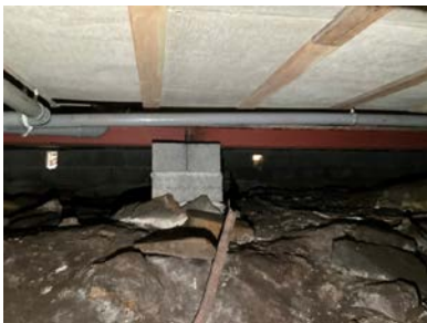
Asbest plater i kryperommet.
