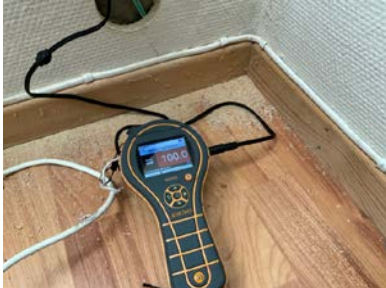
Fritt vann i veggene i kjelleren.
