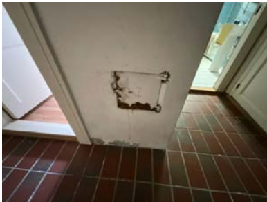
Fukt i bunnen av pipen
