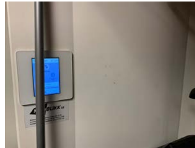
Service på anlegget, ulyder i viftemotor.
