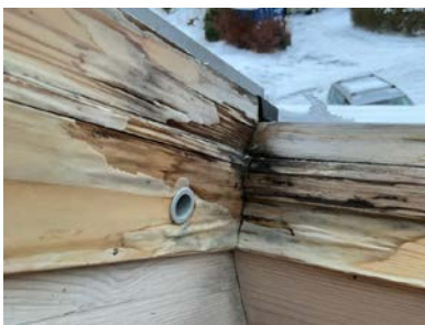
Råteskader i takvindu.
