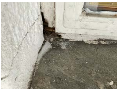
Liten råteskade i bunnen.
