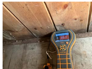
Fukt i overgang mellom grunnmur og treverk.
