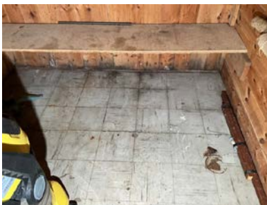
Fuktmerker i boden.
