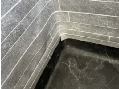
Belegg har løsnet i skjøt.
