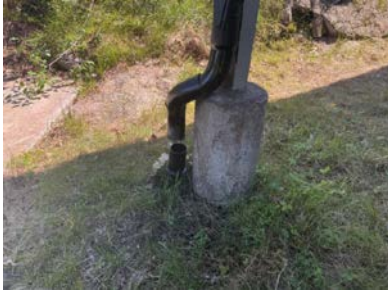
Nedløp er ikke påkoblet dreneringsrør.
