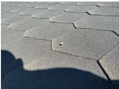
Takteking er feil innfestet.
