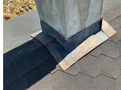
Eldre beslag rundt pipe.
