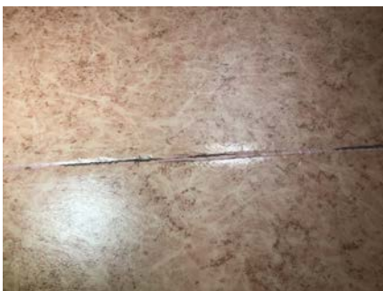
sprekker i belegg
