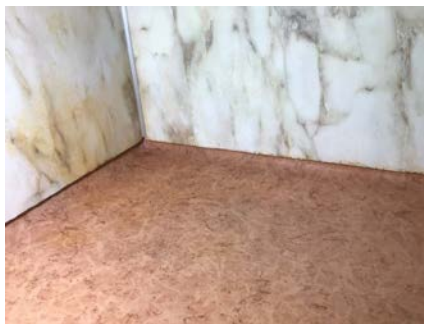
Fukt i nedkant våtromsplater i dusj
