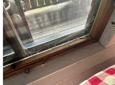
Fuktskader på innvendig vinduskarm.
