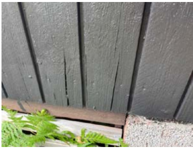
Sprekkdannelser i enkelte kledningsbord.
