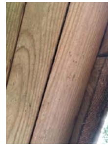
Manglende lufting bak kledning.
