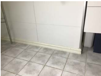
List langs gulv med fare for fuktskader
