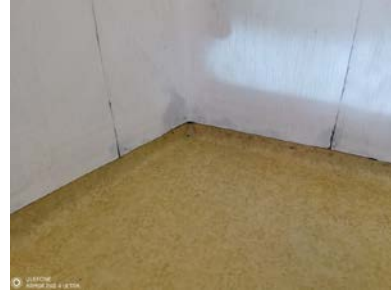
Plater på vegg i dusjsone har skader i overflate
