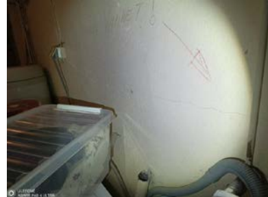
Horisontal riss i grunnmur
