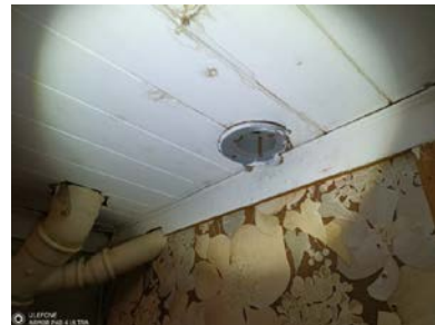
Naturlig ventilering i himling
