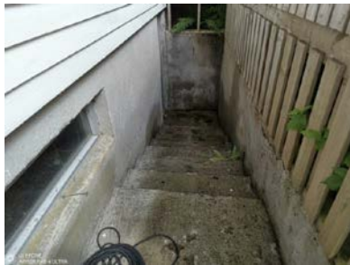
Det er ikke håndløper på vegg.
