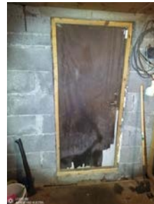
Kjellerdør har skader i overflate
