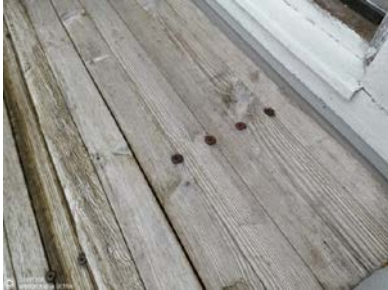
Rustdannelse på skruer som ikke er egnet for utvendig bruk.
