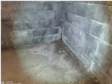
Saltutslag og spor etter fukt i kjeller
