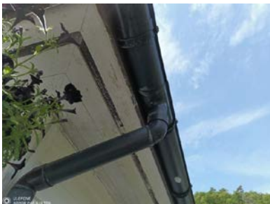
Det er spor etter punktvis lekkasjer i renner og nedløp
