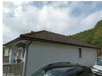
Taket har ikke montert snøfangere
