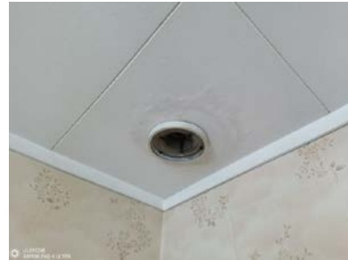
Skade i himling rundt ventil
