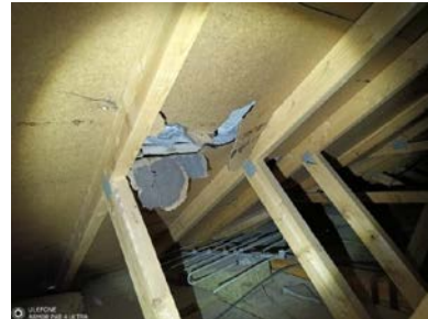
Skade på undertak.
