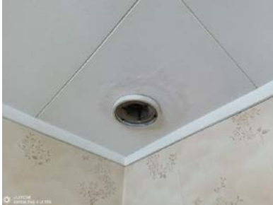
Det er fuktskader rundt ventil i himling
