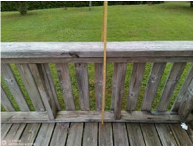
Rekkverk er lavere enn dagens krav
