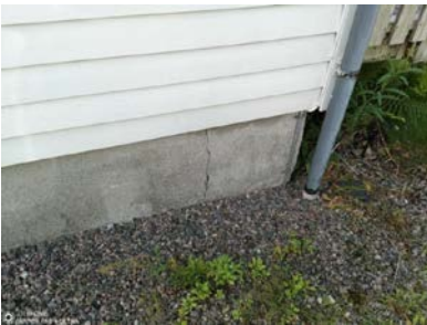
Utvendig synlig sprekk i grunnmur
