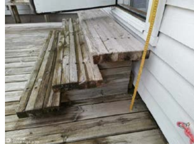
Trapp har ikke rekkverk
