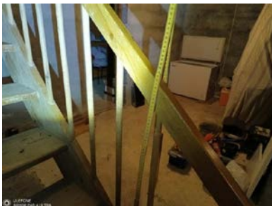
Rekkverk er lavere enn dagens krav
