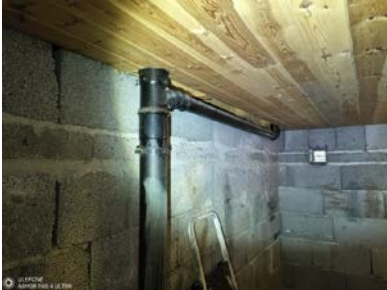
Eldre avløpsrør i plast
