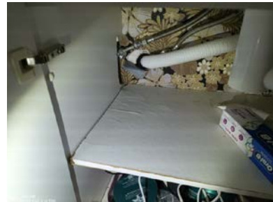
Innredning har fuktskader
