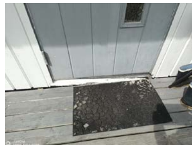
Skader på beslag under hovedytterdør
