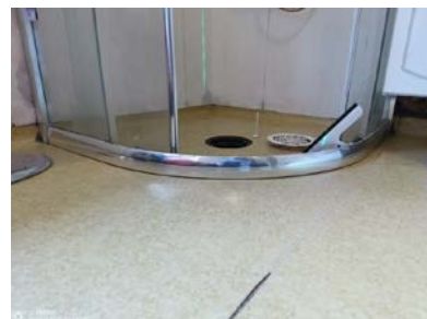
Kant på dusjvegger hindrer vann utenfor dusjsonen å renne til sluk
