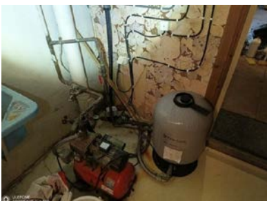
Trykktank lokalisert på vaskerom i kjeller.
