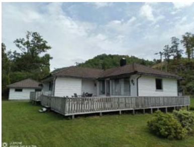
Taket har ikke montert snøfangere
