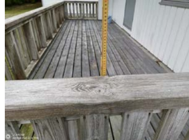
Rekkverk er lavere enn dagens krav
