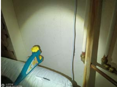
Riss i pusset overflate
