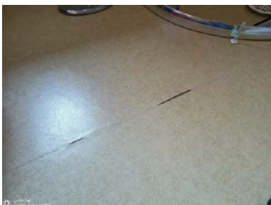
Sprekk/ skade i belegg
