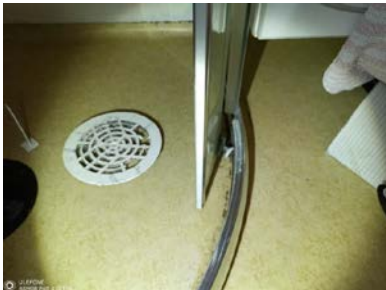
Dør på dusjvegger er løs
