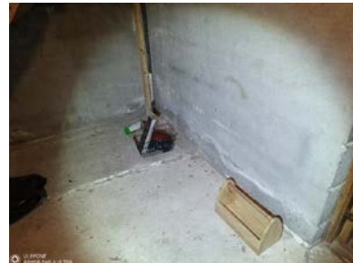
Saltutslag på kjellervegg.
