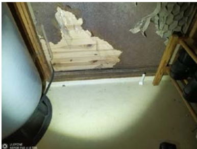
Rommet har ikke etablert tilluft spalte eller tilsvarende i dør.
