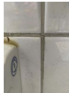
Sprekt flis og løs fuge over toalettet
