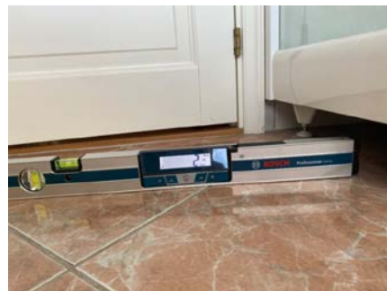
Fall fra flis ved dør mot sluk
