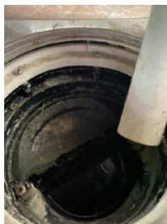
Ingen synlig membran under klemringen.
