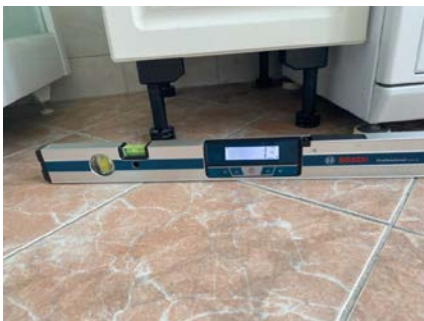
Fall mot sluk, tilnærmet flatt gulv.
