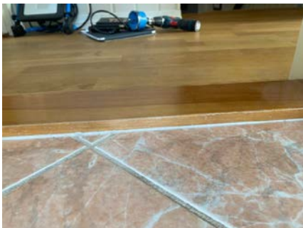
Ingen membranoppkant ved dørterskel.
