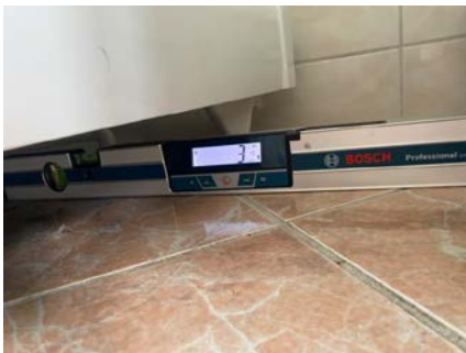
Fall mot sluk fra vaskemaskin
