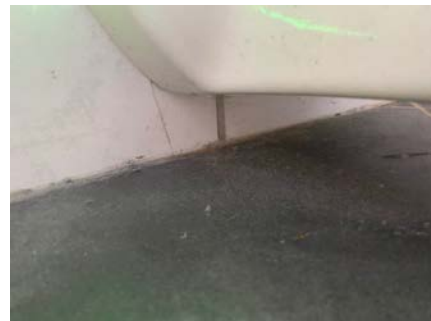
Sprekt flis under toalett
