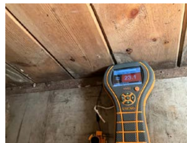
Fukt i overgang mellom grunnmur og treverk.
