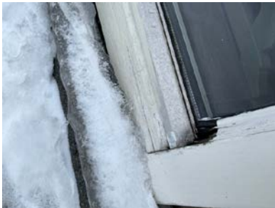
Råteskader i bunnen av døren.
