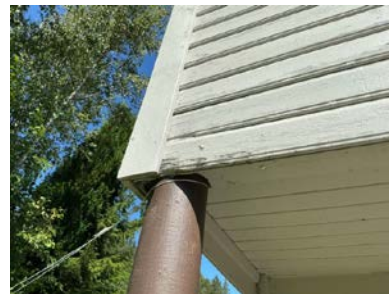
Synlige råteskader høyt oppe på vegg.
