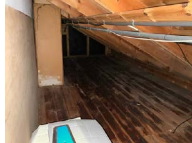
Flere eldre merker i undertaket.
