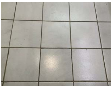
Flere løse fliser på gulvet.
