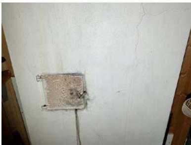
Flere riss i overflaten.
