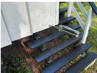
Mykt treverk/råte i bunn av kledning.
