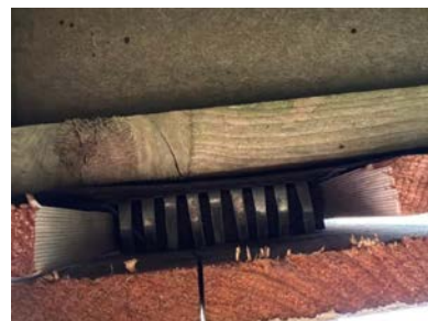
Manglende luftespalte bak kledning.
