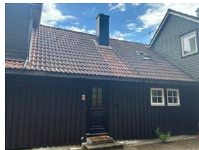
Manglende snøfangere over inngangsparti.
