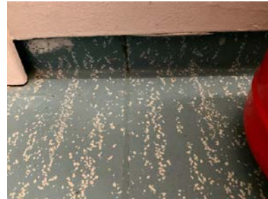
Sprekker i belegget.
