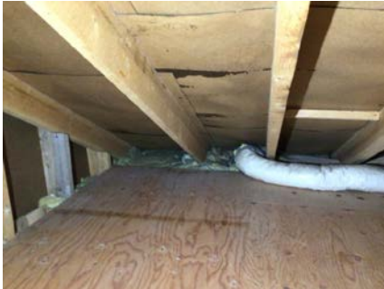
Mangelfull luftespalte i nedkant
