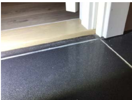
Mangler oppkant under dør
