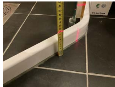
Tett oppkant mot dusjen, lekkasjevann vil bli liggende på gulvet.
