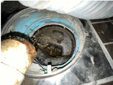
Synlig membran i sluken.
