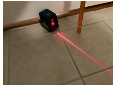
Manger fall på gulvet og oppkant ved dør.
