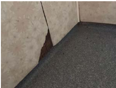
Fukt/råteskade i våtromsplater.
