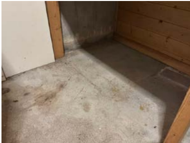
Saltutslag på vegg i kjeller.
