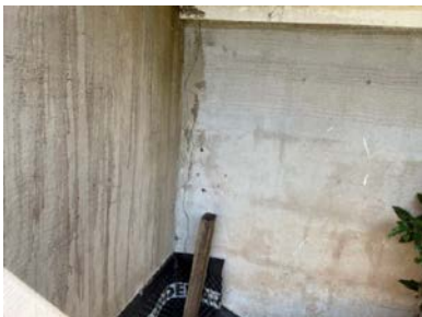
Vertikal sprekk i grunnmur.
