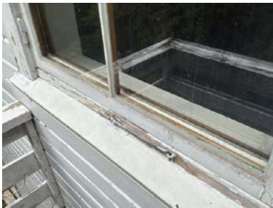
Vindu av eldre dato med høy slitasje.
