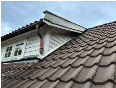
Råteskader i vindskeer.
