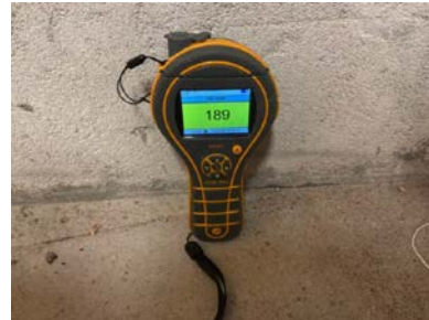
Noe forhøyet fuktverdi i bunn av vegg.
