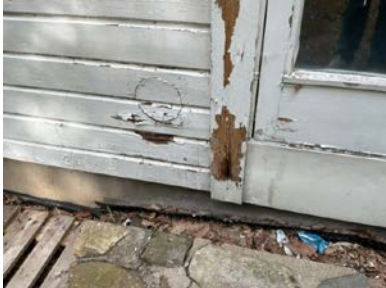
Råteskader i kledning.
