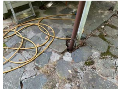
Nedløp ført ned i grunnen av ukjent utførelse.
