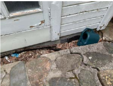
Manglende topplist på utvendig fuksikring.
