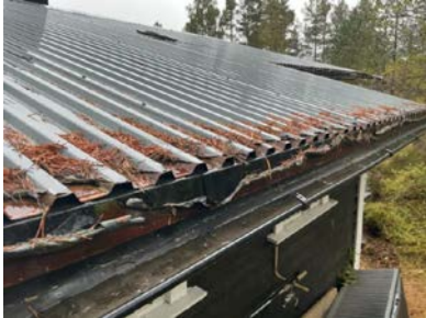
Lekker av takrennene og stedvis motfall.
