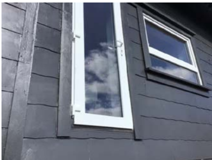
Balkongdør med mangel av sikring
