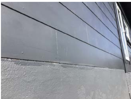
mangler lufting bak plater og museband
